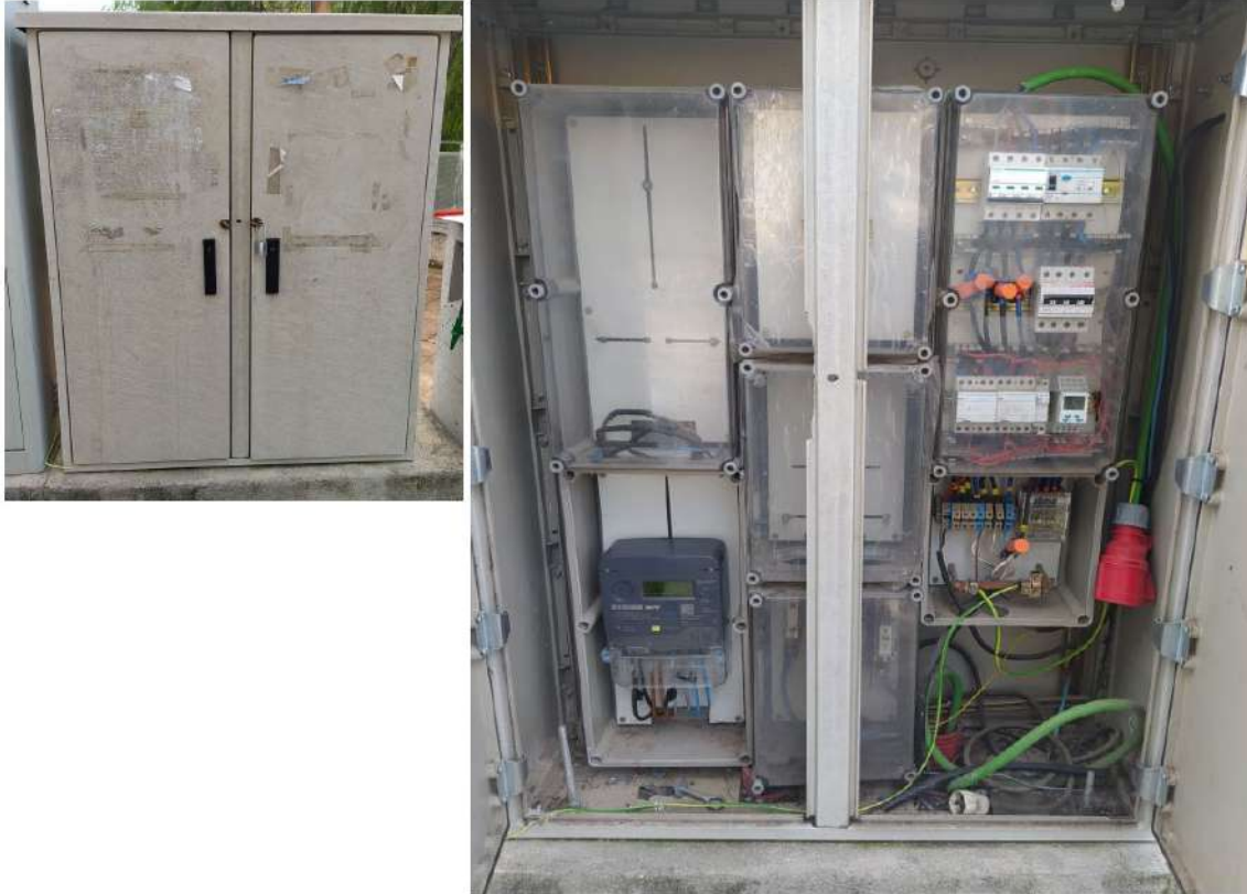
Quadre elèctric Q02
