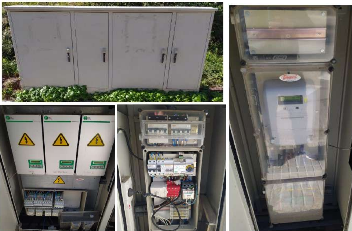
Quadre elèctric Q06
