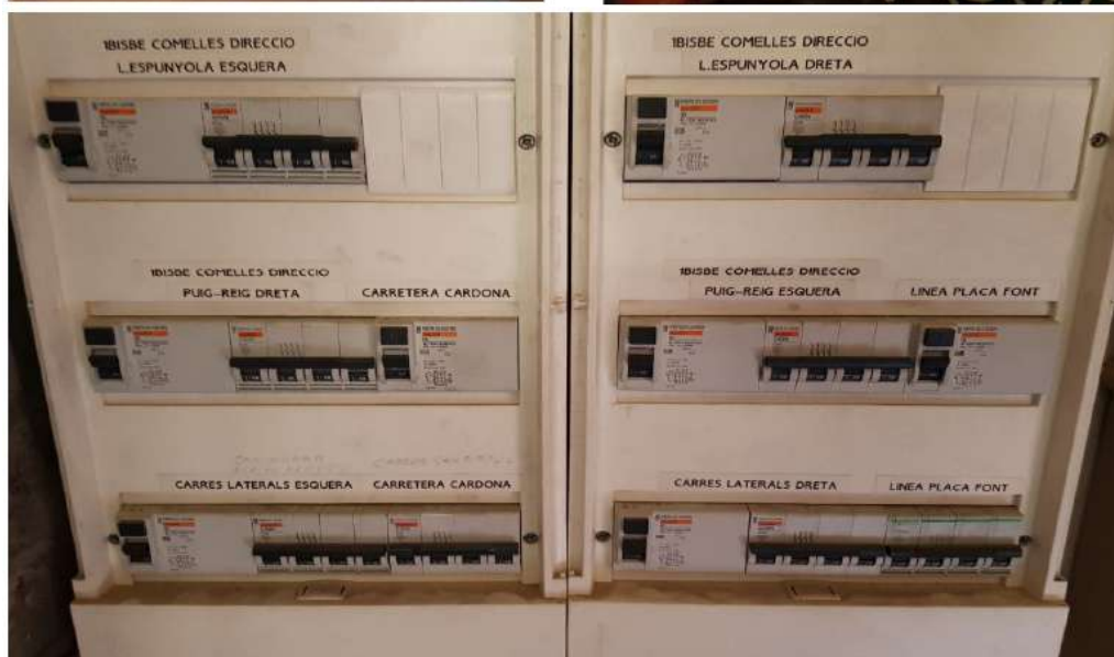
Quadre elèctric Q03
