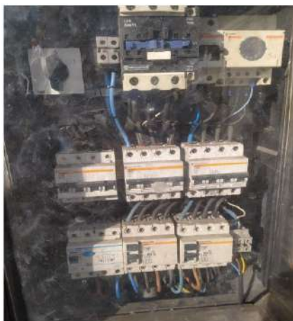
Quadre elèctric Q08
