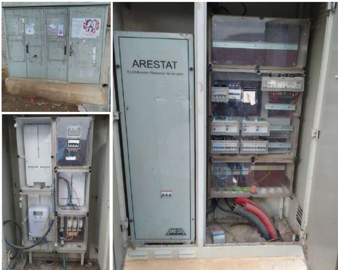
Quadre elèctric Q07
