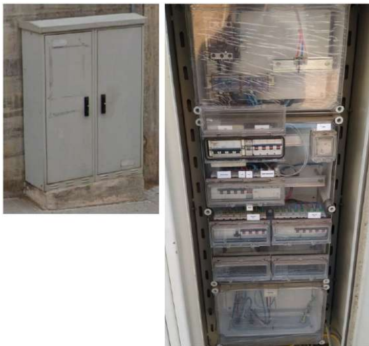
SubQuadre elèctric Q04
