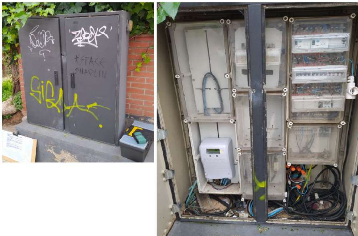
Quadre elèctric Q01
