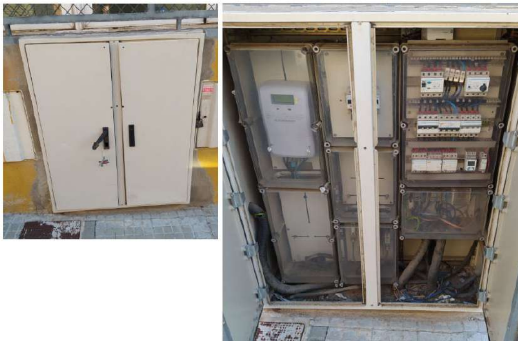
Quadre elèctric Q04
