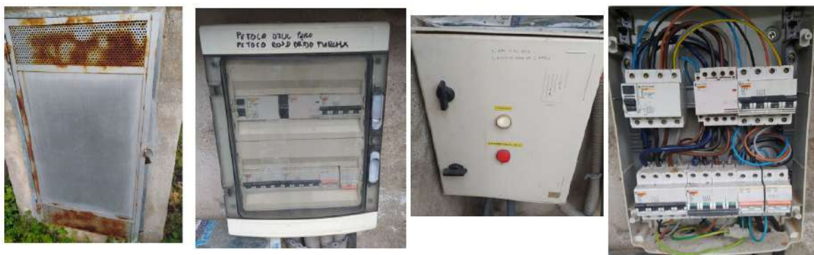
SubQuadre elèctric Q08
